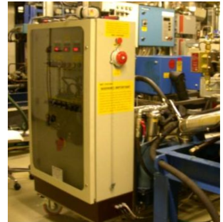
Wärtsilä Wetpac E-system
